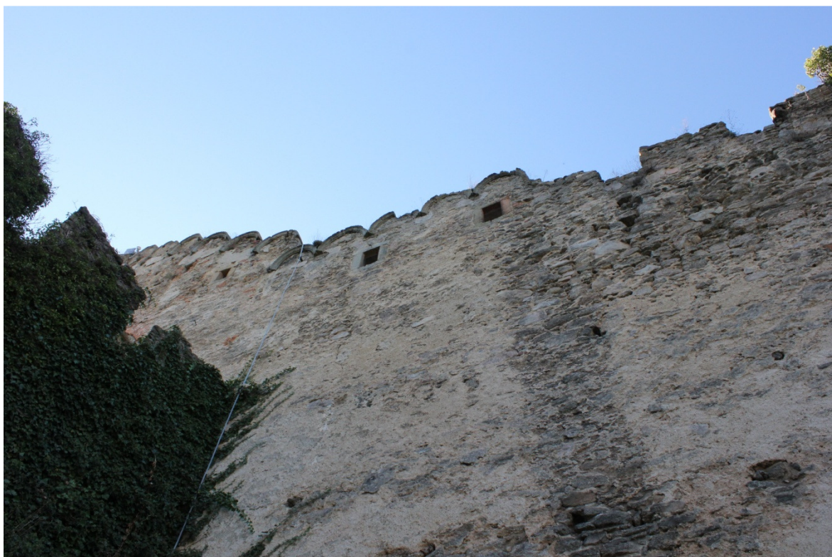
Fot. 14. Mur wschodni. Ubytki zaprawy.
