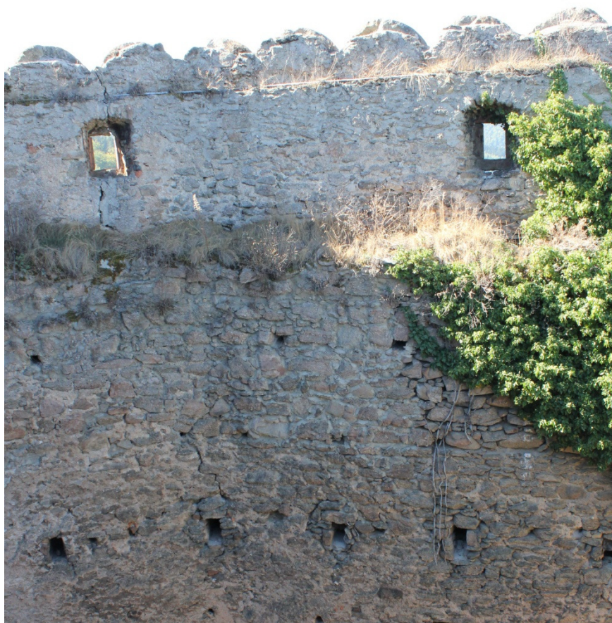
Fot. 8. Mur zachodni. Ubytki zaprawy i pęknięcie w murze.
