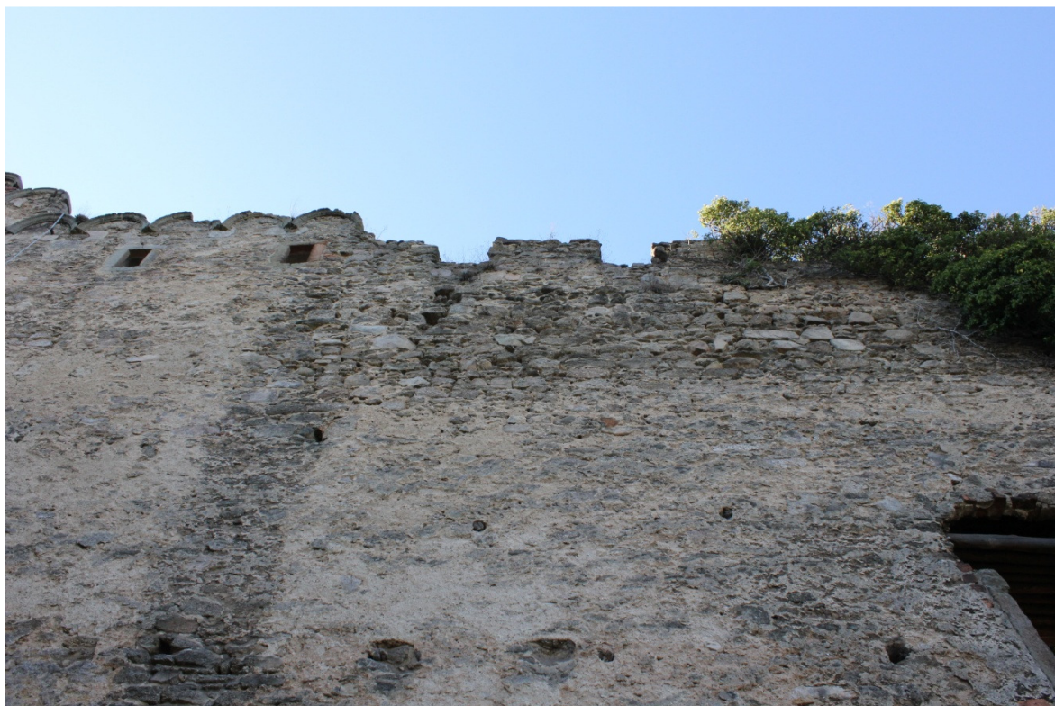
Fot. 13. Mur wschodni. Ubytki zaprawy.
