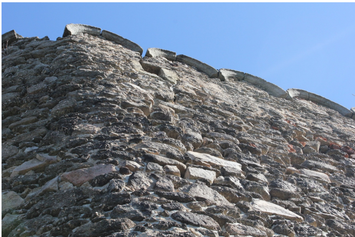
Fot. 9. Mur zachodni. Ubytki zaprawy i pęknięcia w murze.
