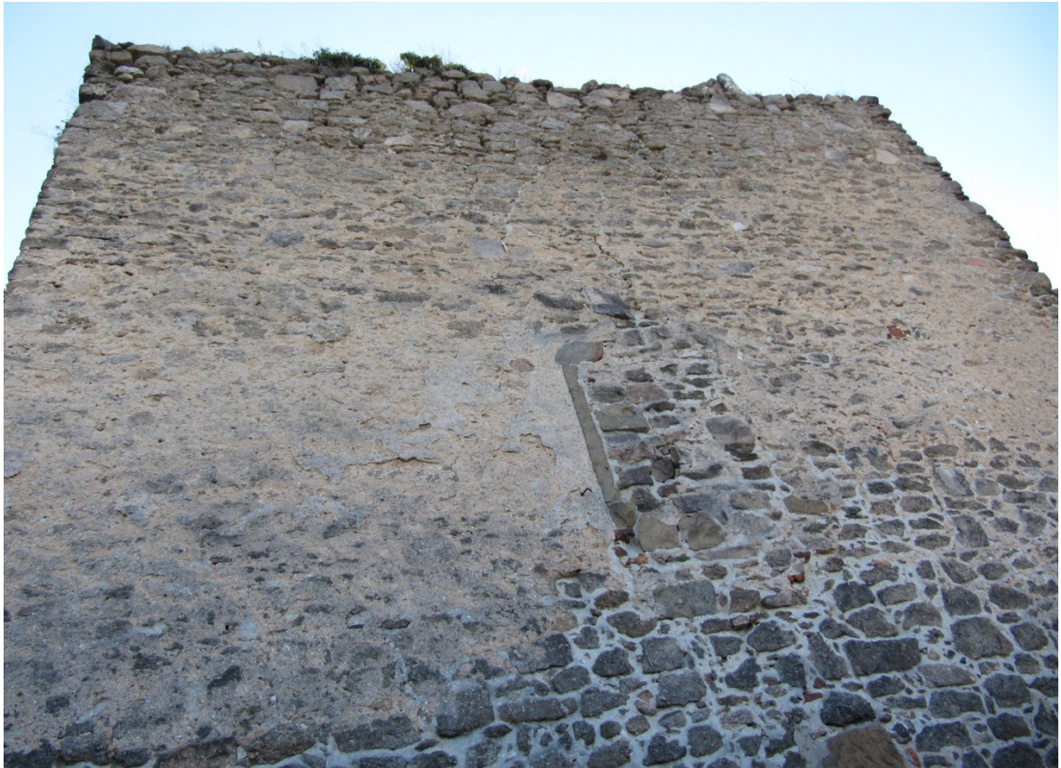
Fot. 11. Mur północny. Ubytki zaprawy, pęknięcie nad zamurowanym otworem okiennym i spoinowanie zaprawa cementowa.
