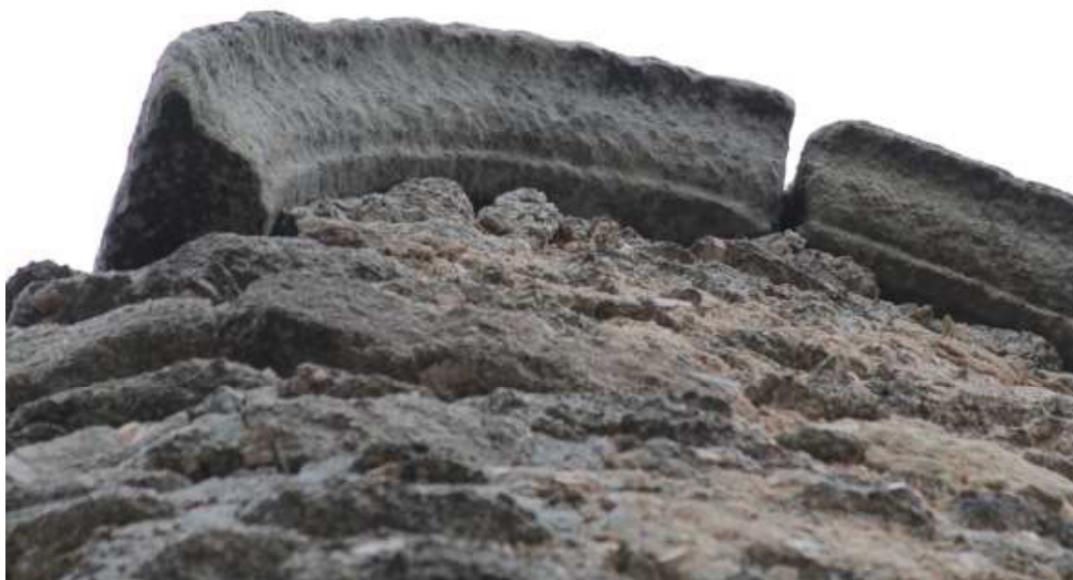
FOT. 15 - Zamek Wysoki, elewacja północna, fragment – stan zachowania powierzchni piaskowca.
