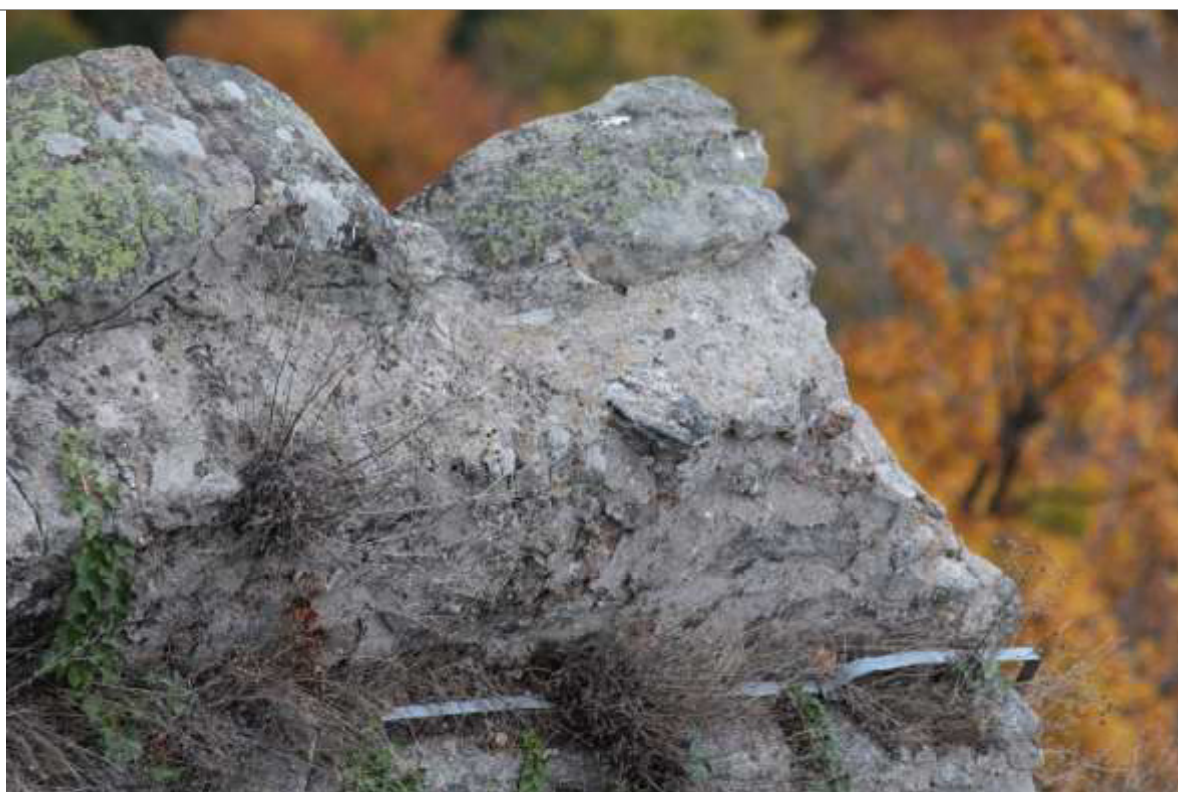
FOT. 17, 18 - Zamek Wysoki, mur południowy, zwieńczenie – końcowy, zachodni odcinek krenelażu Widok ogólny od strony dziedzińca i fragment.
