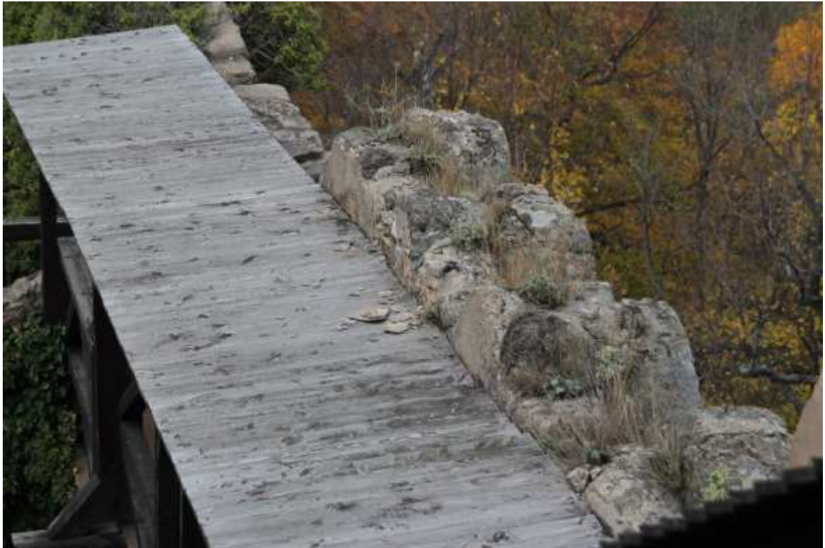
FOT. 33 - Zamek Wysoki, mur północny, zwieńczenie – zachodni odcinek krenelażu, widok ogólny na górną powierzchnię zębów, widok z wieży.
