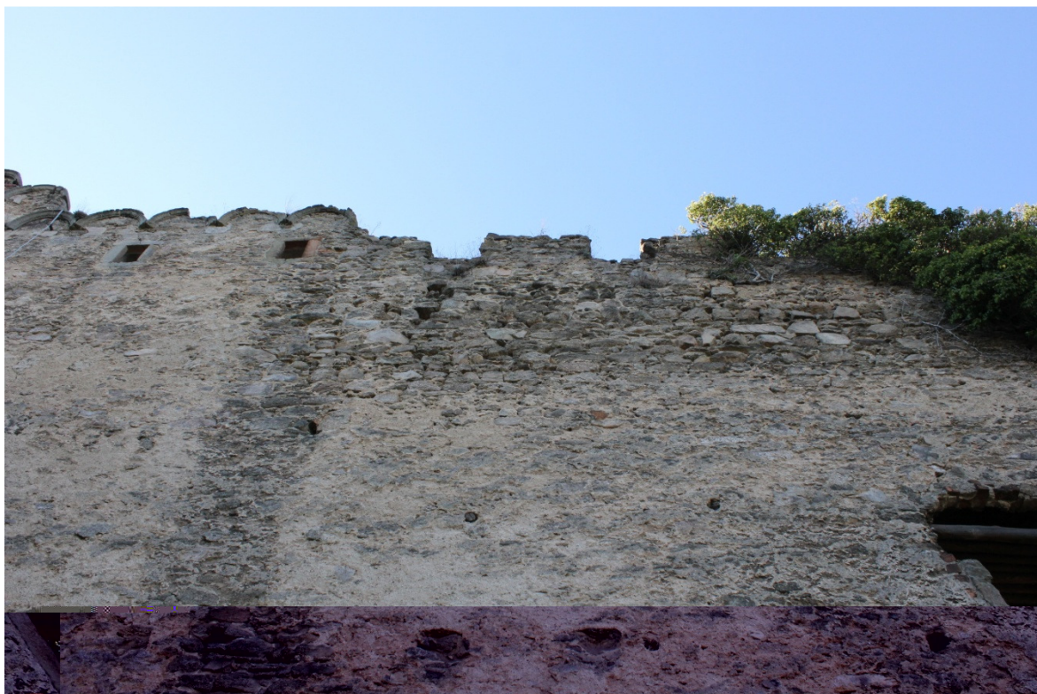
Fot. 13. Mur wschodni. Ubytki zaprawy.
