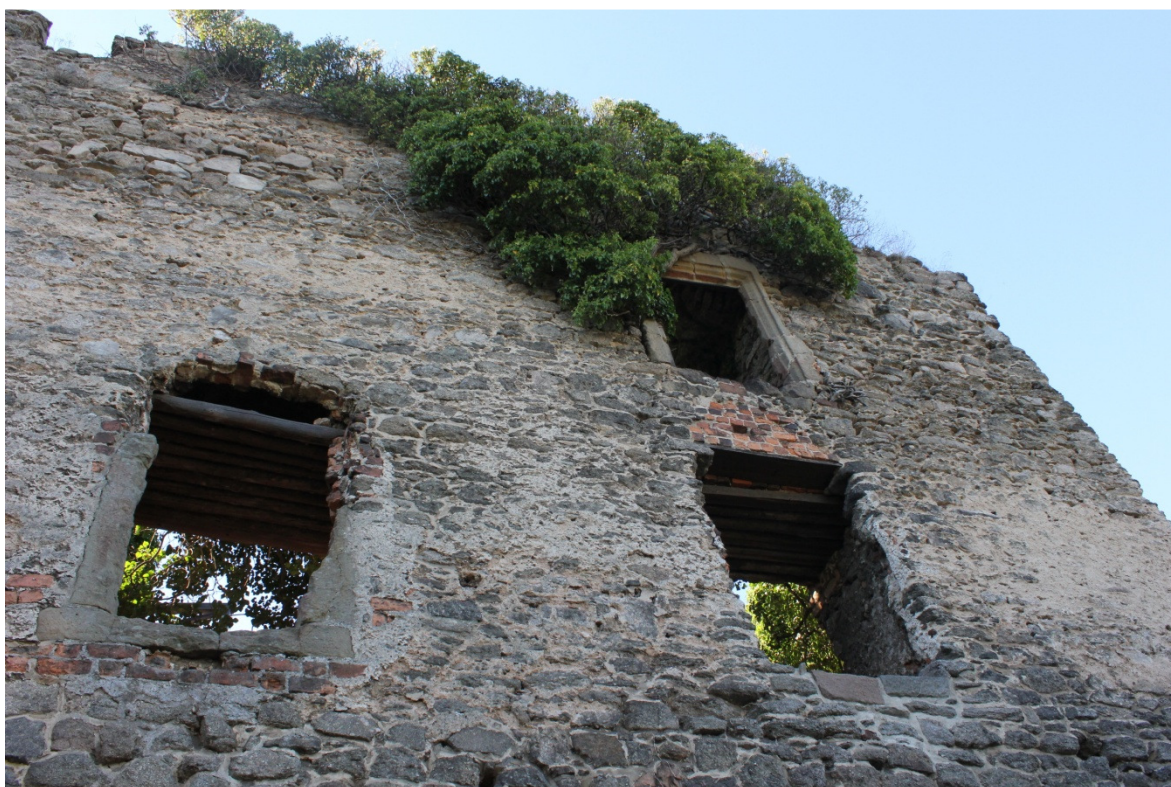
Fot. 12. Mur wschodni. Ubytki zaprawy, przemurowania z cegły i nadproża.
