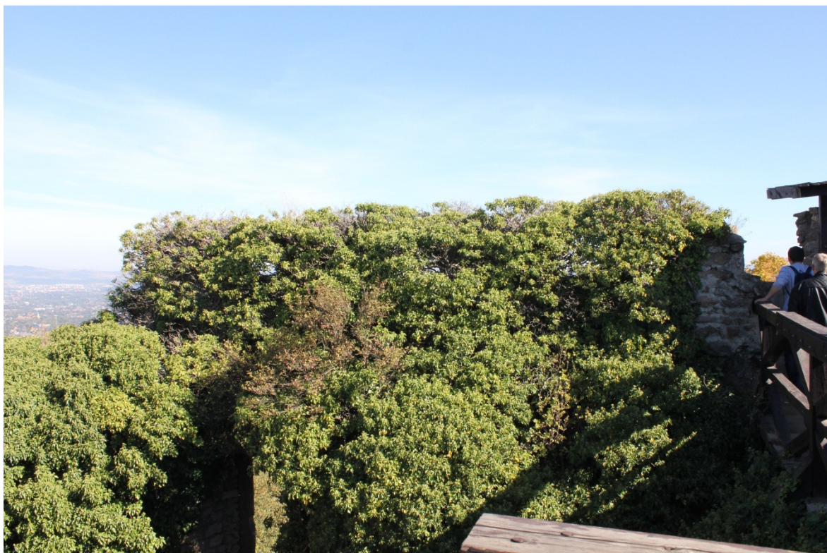
Fot. 6. Mur wschodni. Roślinność porastająca koronę muru.
