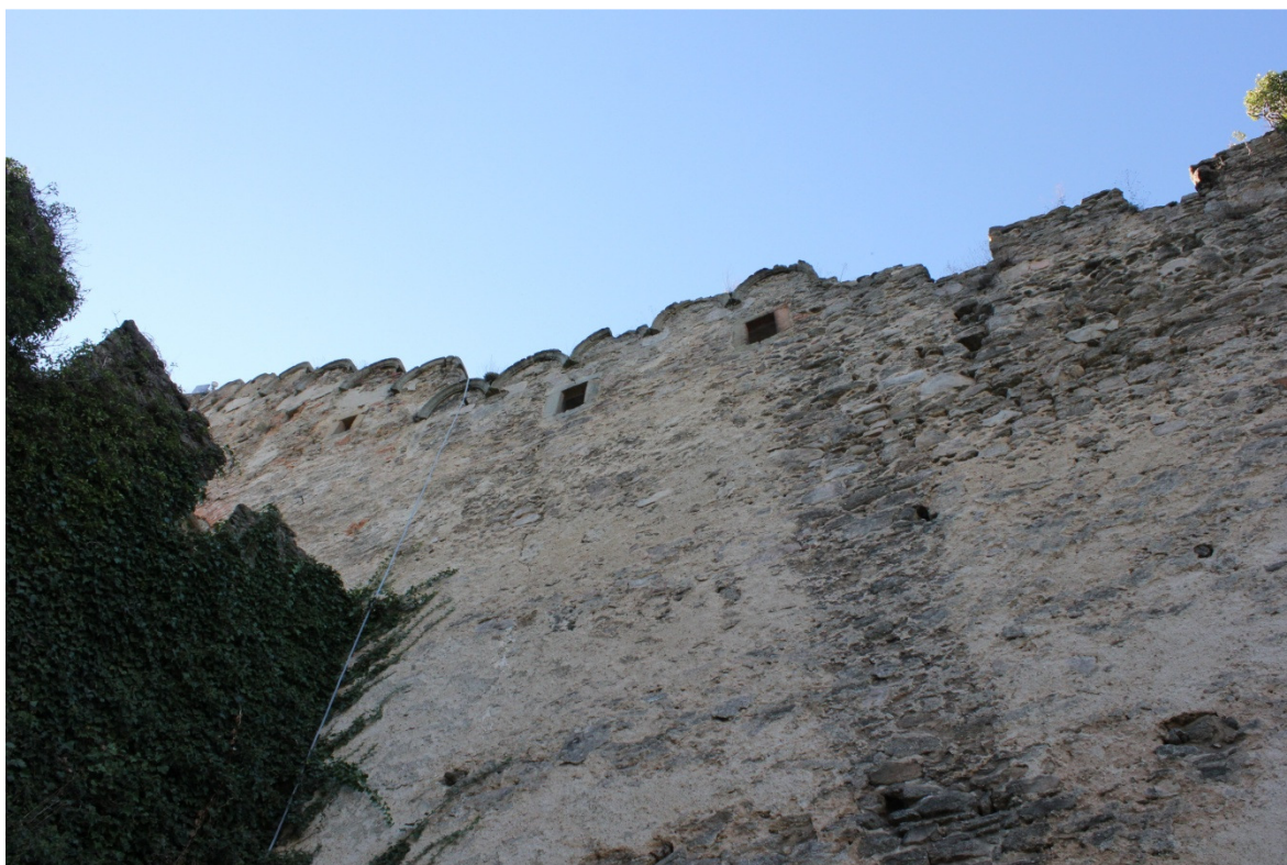
Fot. 14. Mur wschodni. Ubytki zaprawy.
