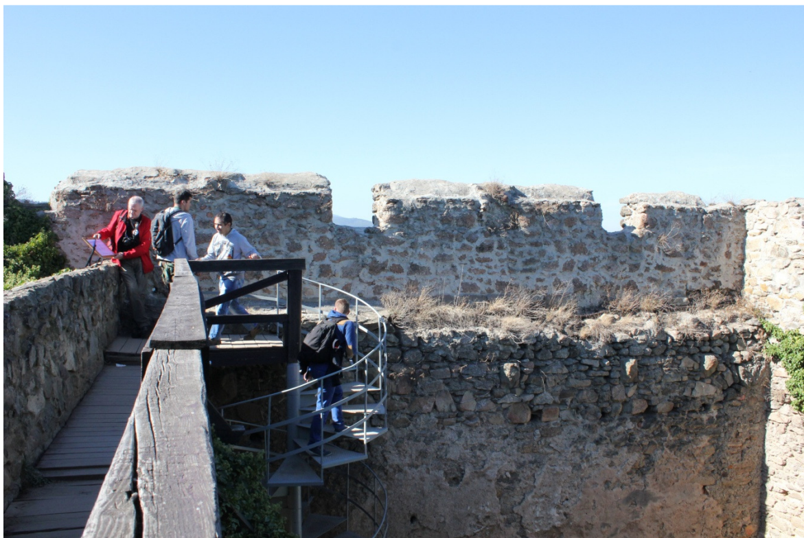
Fot. 7. Mur zachodni. Ubytki zaprawy i spoinowanie zaprawą cementową.
