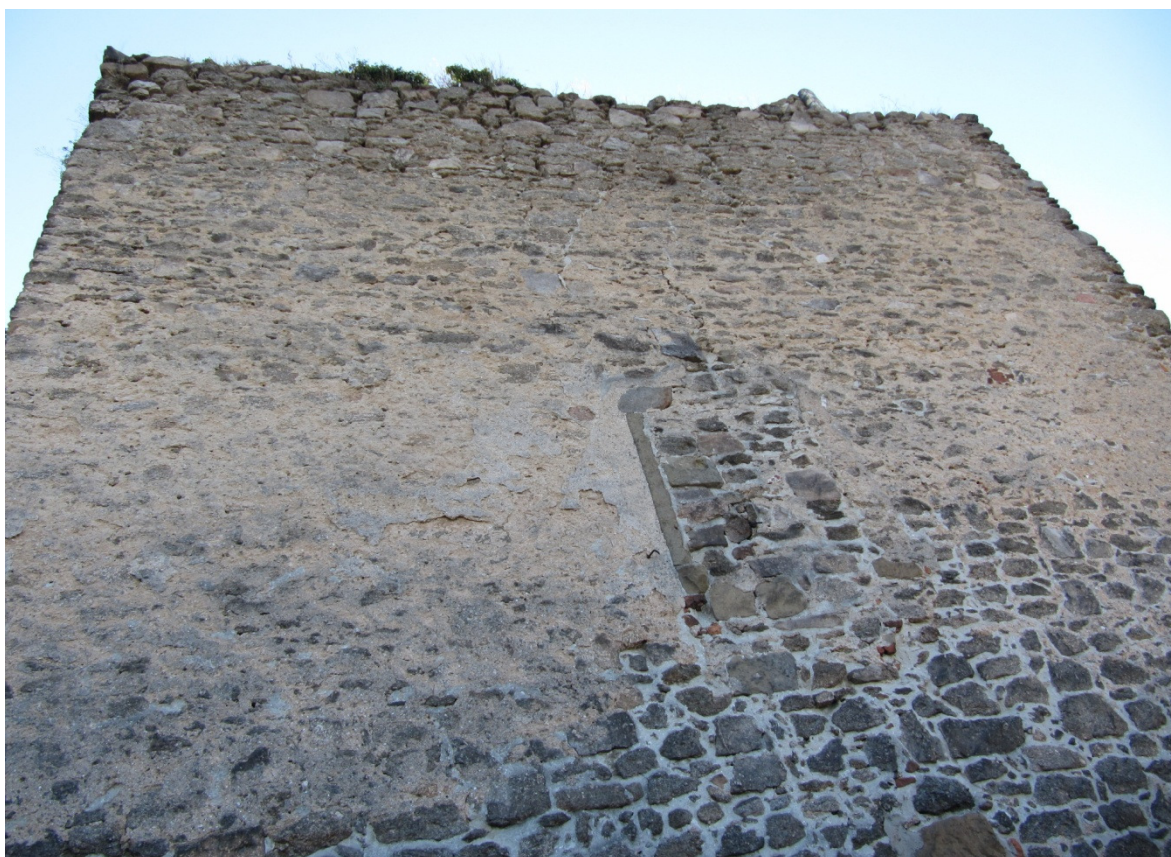
Fot. 11. Mur północny. Ubytki zaprawy, pęknięcie nad zamurowanym otworem okiennym i spoinowanie zaprawa cementowa.
