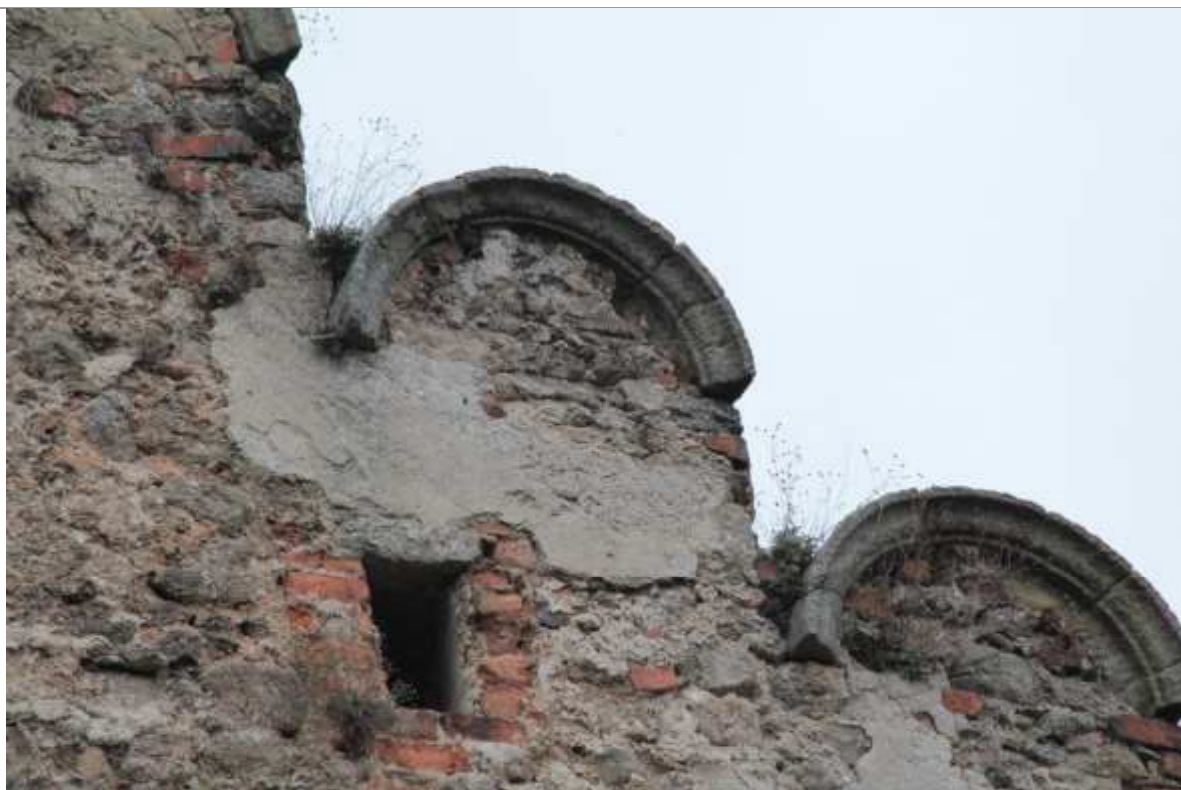
FOT. 23, 24 - Zamek Wysoki, elewacja południowa wschodniej części muru północnego, fragment - zęby krenelażu.
