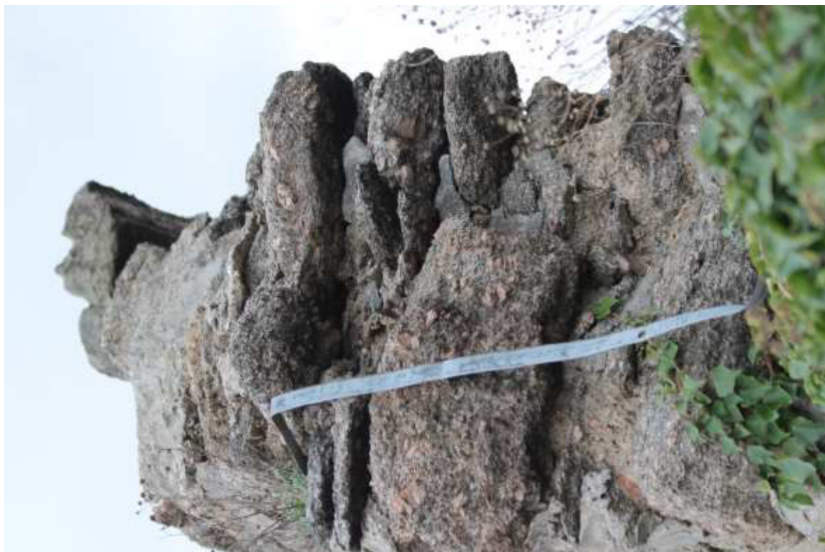
FOT. 19 - Zamek Wysoki, mur południowy, zwieńczenie – końcowy, zachodni odcinek krenelażu, przekrój muru. ←
